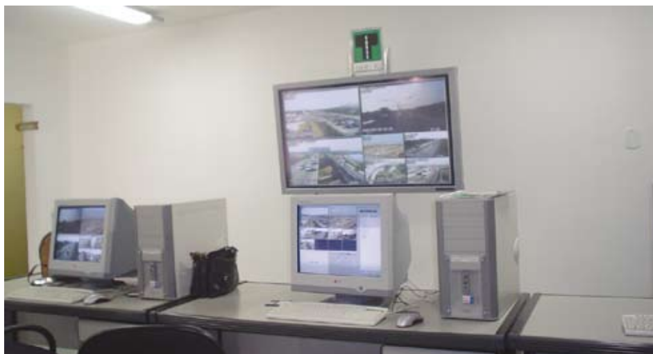
Computadores, no CCO, que monitoram as 16 câmeras dispostas na Linha Vermelha
